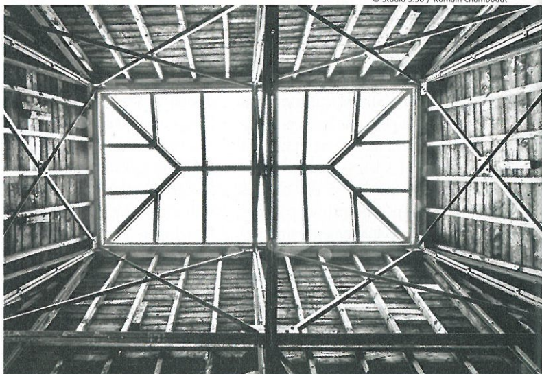
La verrière de l'angle sera transformée en appartement de standing, avec une mezzanine en verre !
